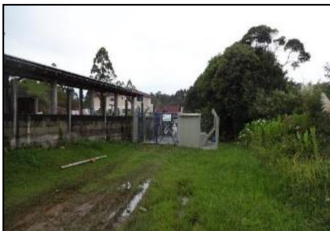
Figura 42: EEE 02 Vista geral. Identificação e cercamento.
