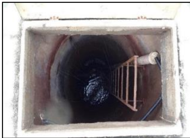
Figura 45: EEE 02. Poço úmido.
