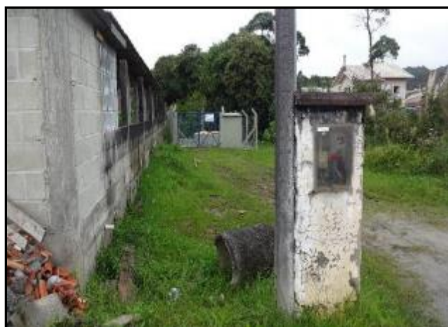
Figura 49: EEE 02. Medidor de energia.
