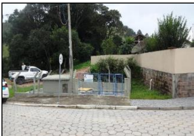
Figura 34: EEE 01. Vista geral. Identificação e cercamento.
