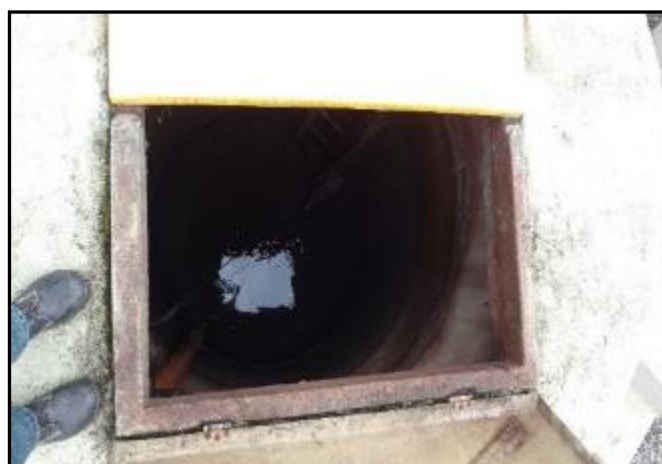
Figura 53: EEE 03. Poço úmido.
