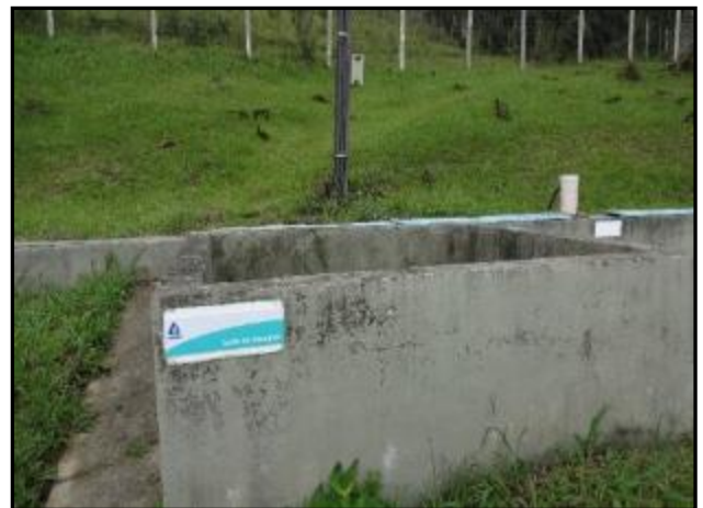
Figura 59: Caixa de acondicionamento dos resíduos do desarenador.
