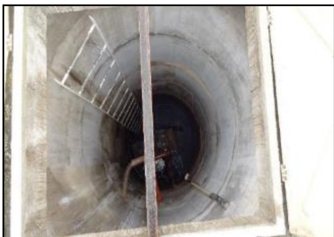
Figura 46: EEE 02. Poço seco das bombas.
