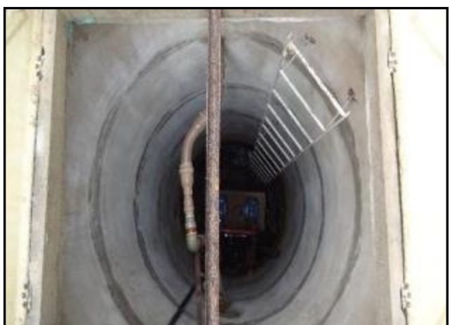
Figura 54: EEE 02. Poço seco das bombas.
