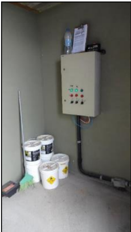
Figura 28: Quadro de comando das bombas da lagoa de aerção.
