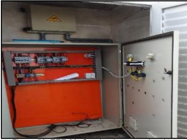
Figura 56: EEE 03. Quadro de comandos da bomba.
