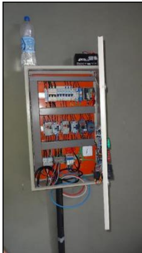
Figura 29: Quadro de comando das bombas da lagoa de aerção.
