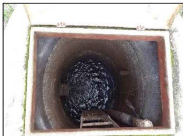
Figura 37: EEE 01. Poço úmido.
