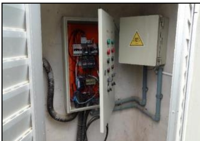
Figura 40: EEE 01. Quadro de comando das bombas.
