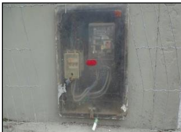
Figura 41: EEE 01. Medidor de energia.
