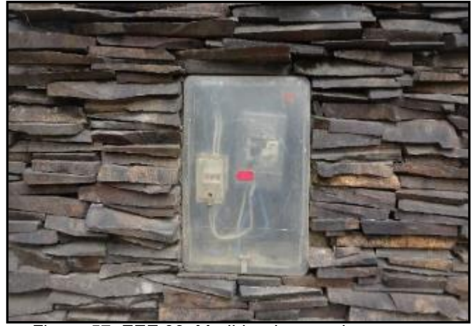
Figura 57: EEE 03. Medidor de energia.
