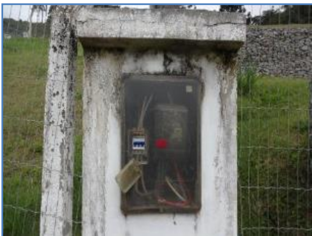
Figura 61: Medidor de energia sem lacre.
