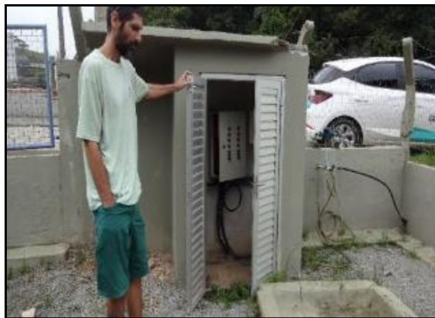
Figura 39: EEE 01. Abrigo do quadro de comando das bombas.
