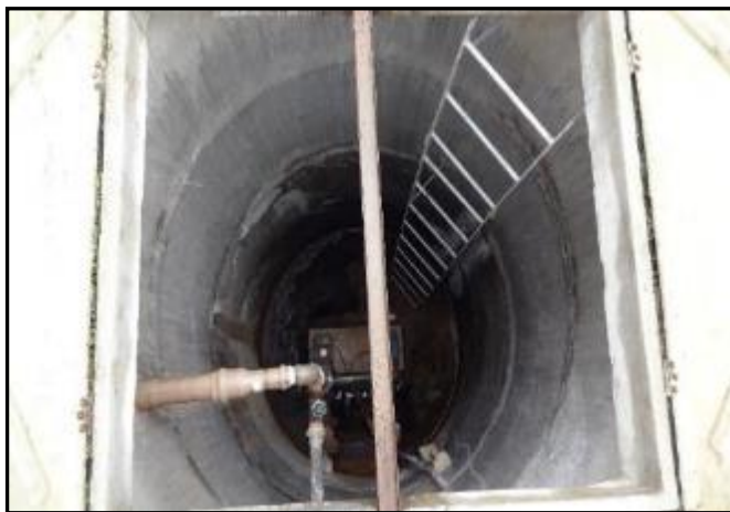
Figura 38: EEE 01. Poço Seco das Bombas.
