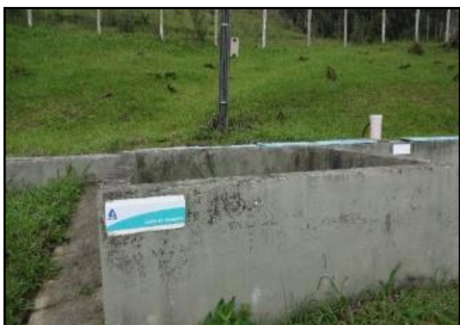
Figura 26: Caixa de acondicionamento dos resíduos do desarenador.
