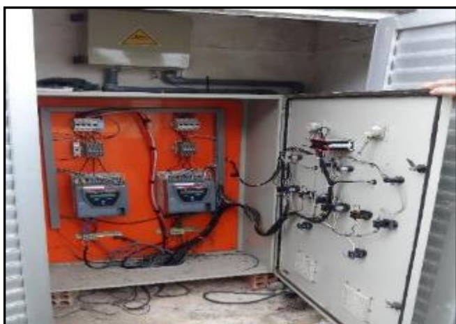
Figura 48: EEE 02. Quadro de comando das bombas.
