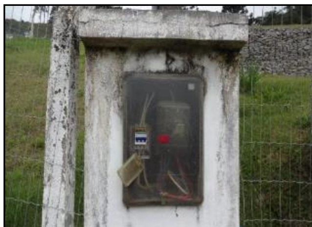
Figura 25: Medidor de energia da ETE Rancho Queimado.
