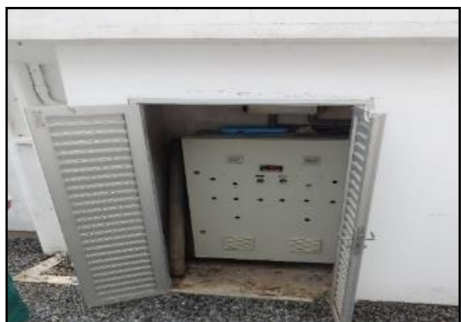
Figura 55: EEE 03. Abrigo dos quadros de comando das bombas.
