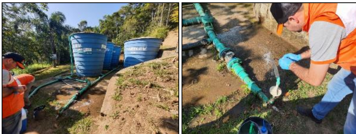
Figura 3: Visão geral do Reservatório e coleta de amostras de água tratada (25/05/2022).
