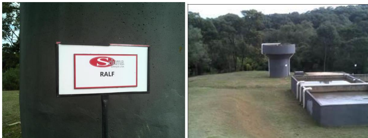
Figura 16: Tratamento de efluentes – Reator Anaeróbico de leito fluidizado
