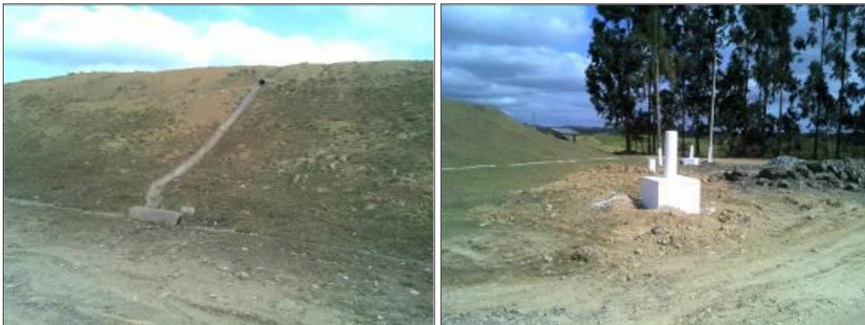
Figura 11: Drenagem de água e gases
