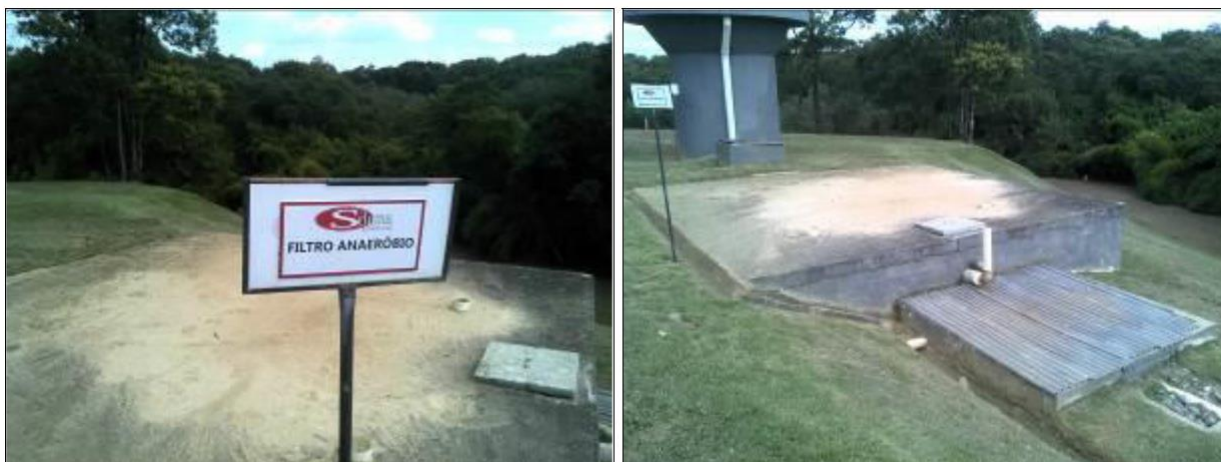
Figura 17: Tratamento de efluentes – Filtro anaeróbico
