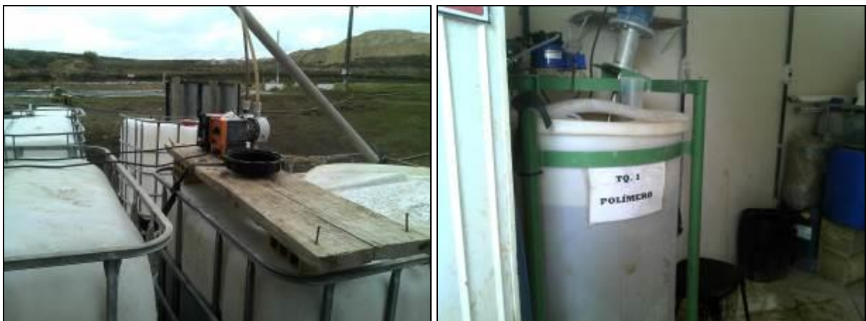
Figura 16: Equipamentos para tratamento do chorume
