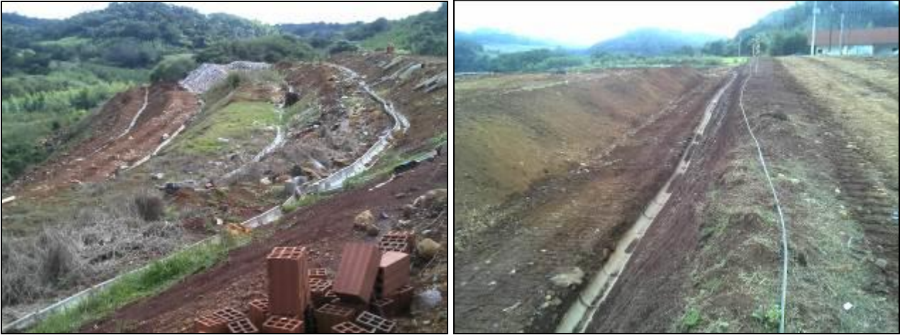
Figura 41: Drenagem de águas superficiais
