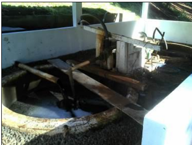
Figura 15: Sistemas de drenagem/tratamento/recalque
