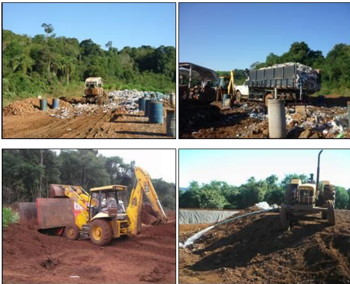
Figura 5: Máquinas e caminhões que operam no Aterro Sanitário
