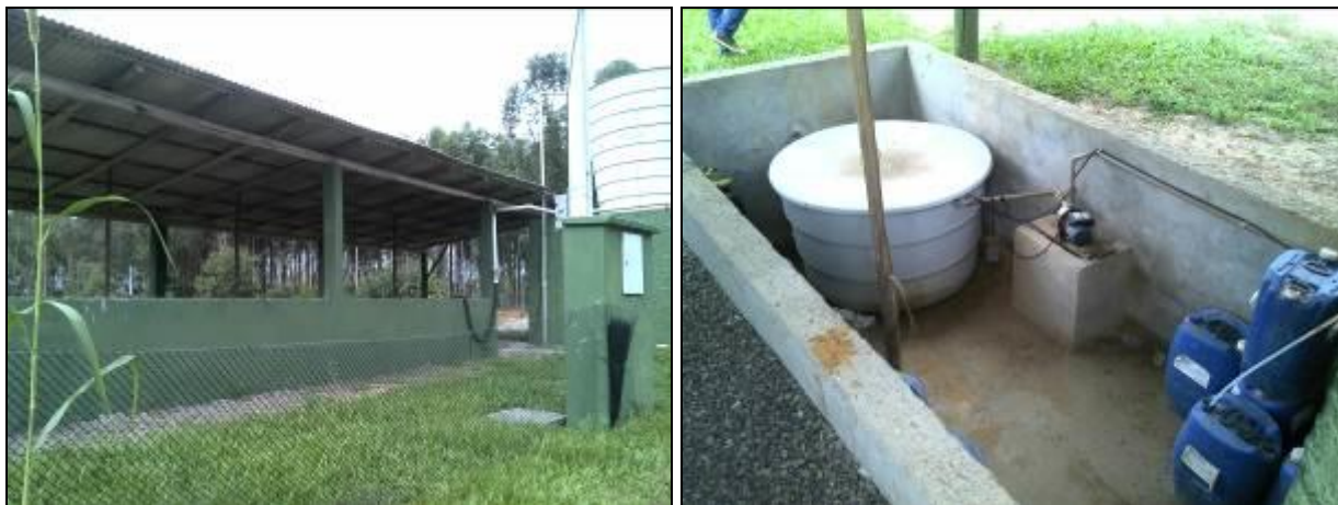
Figura 14: Equipamentos para tratamento do chorume
