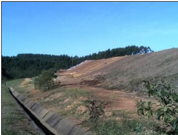
Figura 11: Drenagem de águas superficiais
