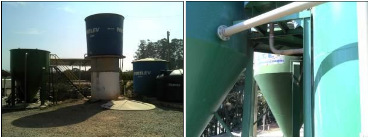
Figura 15: Equipamentos para tratamento do chorume
