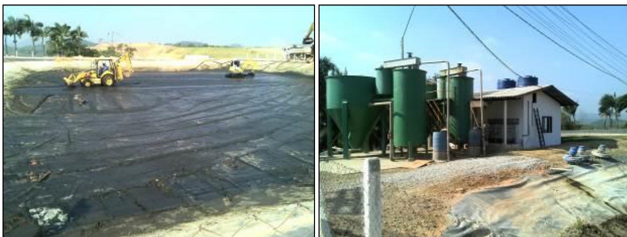
Figura 14: Sistema de tratamento
