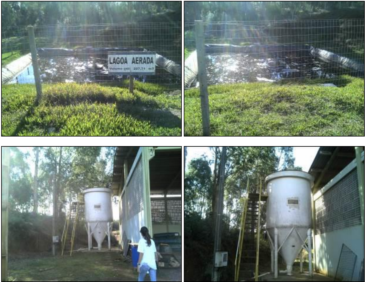
Figura 18: Equipamentos para tratamento do chorume
