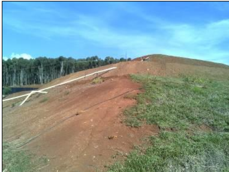
Figura 14: Drenagem de águas superficiais
