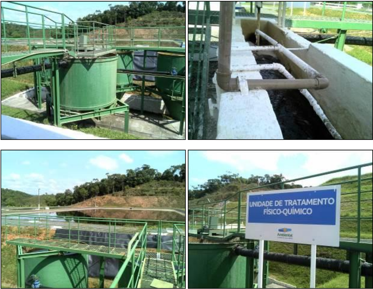
Figura 12: Sistema de tratamento
