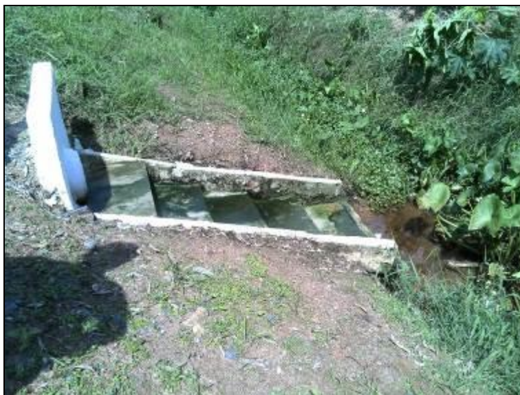
Figura 17: Lançamento de efluente.
