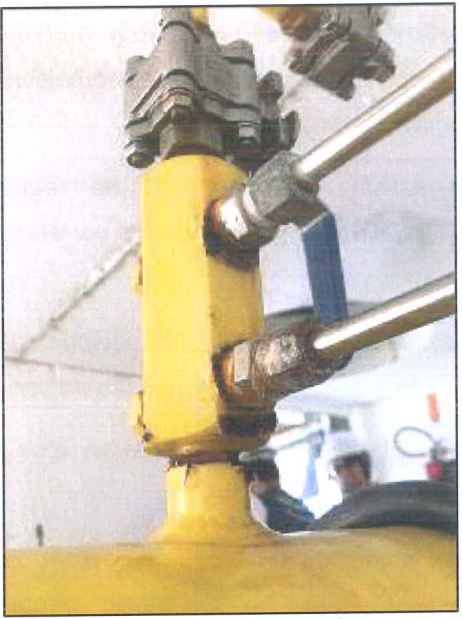
Figura 02 - Conexão com ferrugem.
