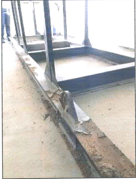
Figura 03 – Base da estrutura com ferrugem.
