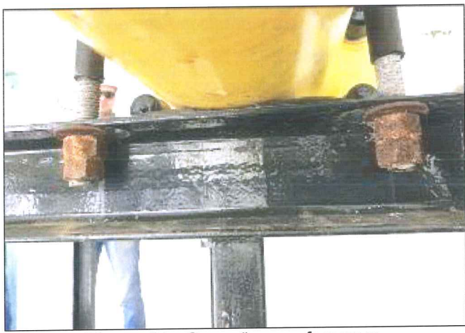
Figura 04 - Conexão com ferrugem.
