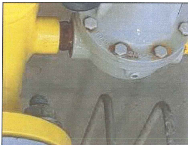
Figura 05 - Conexão com ferrugem.
