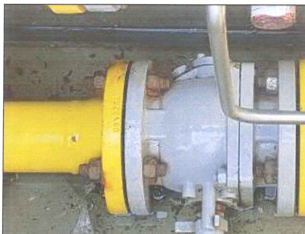
Figura 06 - Conexão com ferrugem.
