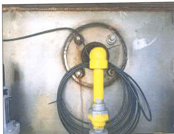
Figura 12 – Arruela de pressão e porcas com ferrugem.
