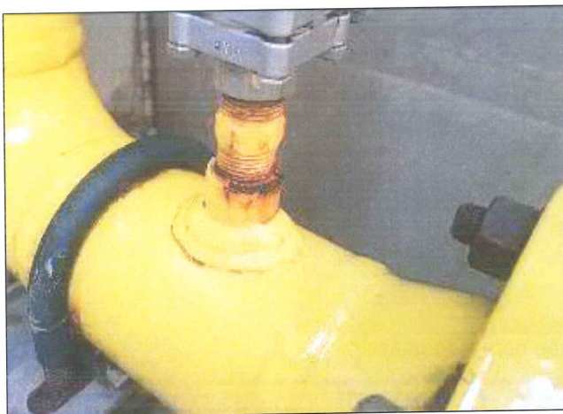
Figura 10 – Conexão com ferrugem.
