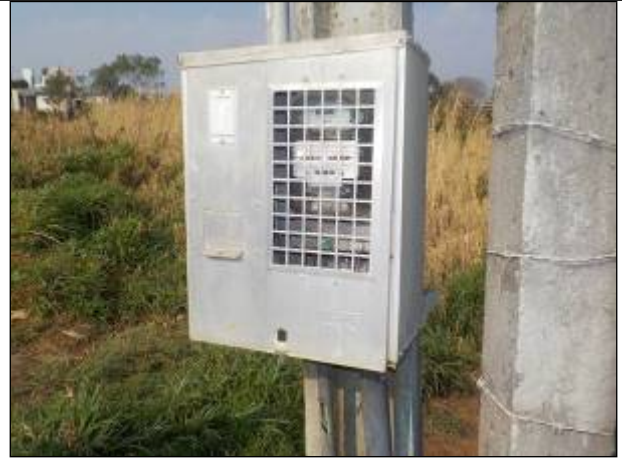
Figura 128: Vista do medidor de energia elétrica junto à EEE 01.
