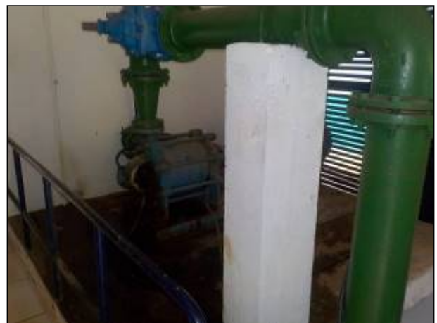
Figura 54: Vista da bomba que faz o recalque da água já tratada, denominada ERAT 01.
