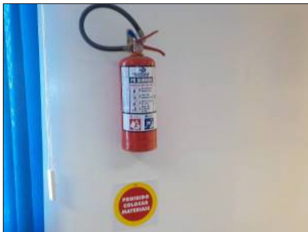
Figura 7: Cilindro contendo pó químico extintor de incêndio em boas condições de uso (pressão, lacre e casco)
