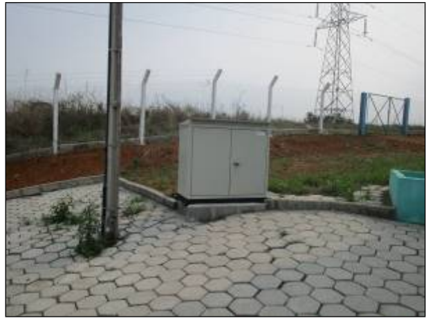
Figura 88: Equipamento junto ao reservatório do Casagrande
