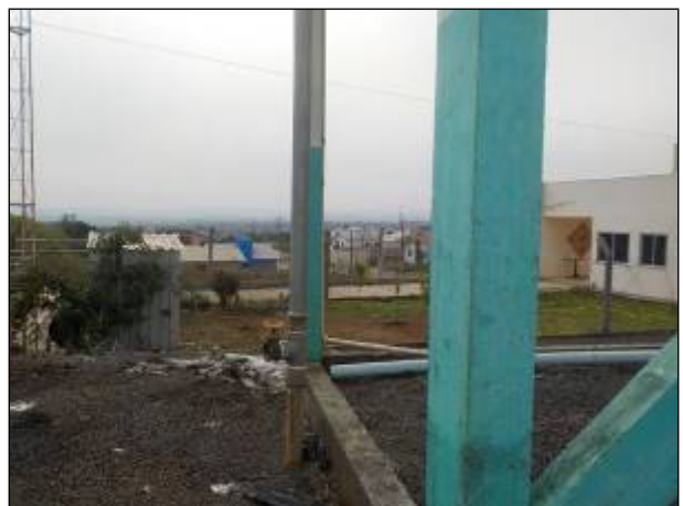
Figura 84: Vista em detalhe da parte de trás do R-07, com o registro para controle da vazão de saída da água reservada.
