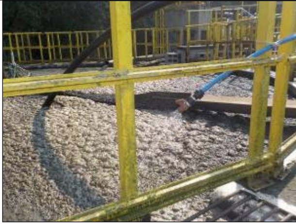
Figura 103: Detalhe do Tanque de Aeração em funcionamento.
