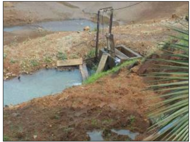
Figura 28: Vista em detalhe da estrutura de Captação de Água Bruta montada para o momento que está sendo realizada a manutenção da Barragem de Captação.
