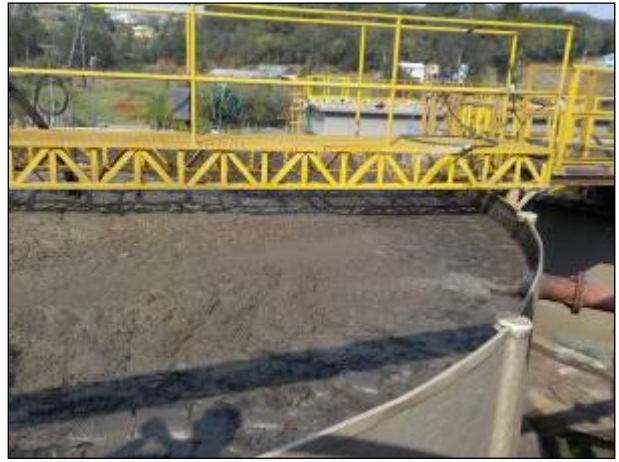
Figura 106: Vista parcial do tanque de aeração, em funcionamento.
