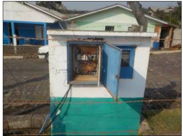
Figura 130: Vista do Painel de Controle e do medidor de energia elétrica localizados na área da EEE 02.
