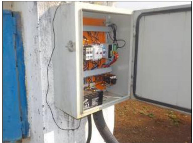
Figura 142: Detalhe do Painel de Controle da EEE 06 instalado na área da EEE 04; a EEE 06 está a cerca de 100 metros deste ponto, em cota mais baixa.
