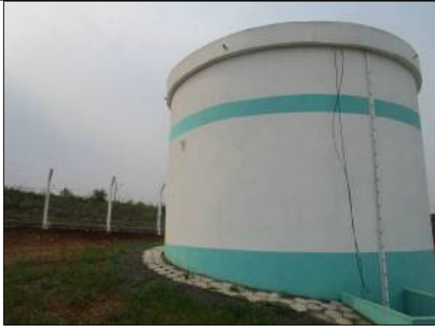
Figura 85: Vista parcial do reservatório a ser ativado, ainda não fazendo parte do sistema público de abastecimento de Catanduvas, localizado no Casagrande.
