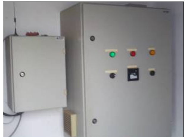
Figura 58: Painel de controle da ERAT 03, pode ser observado o sistema de supervisão à distância na esquerda da imagem.
