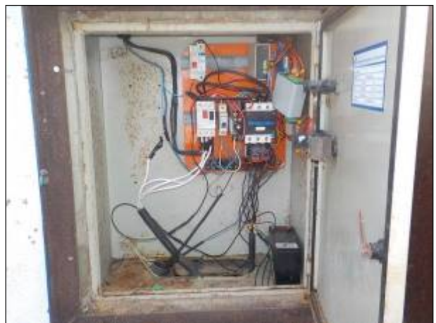
Figura 144: Vista em detalhe da seção interna do Painel de Controle da EEE 04.
