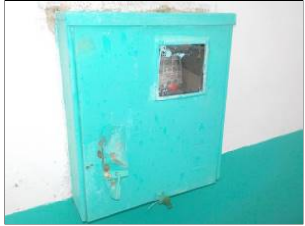
Figura 32: Detalhe do local onde está localizado o Medidor de energia Elétrica do Poço 02.
