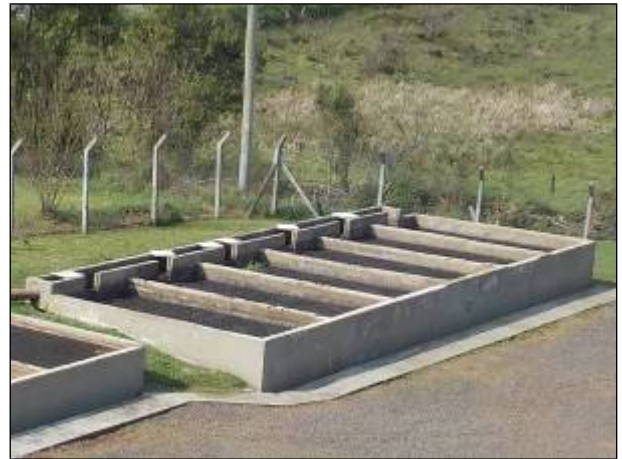
Figura 114: Vista de um dos leitos de secagem de lodo na ETE Catanduvas.
