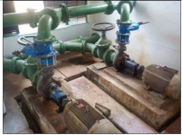
Figura 56: Vista das bombas que fazem o recalque da água já tratada, denominada ERAT 02.
