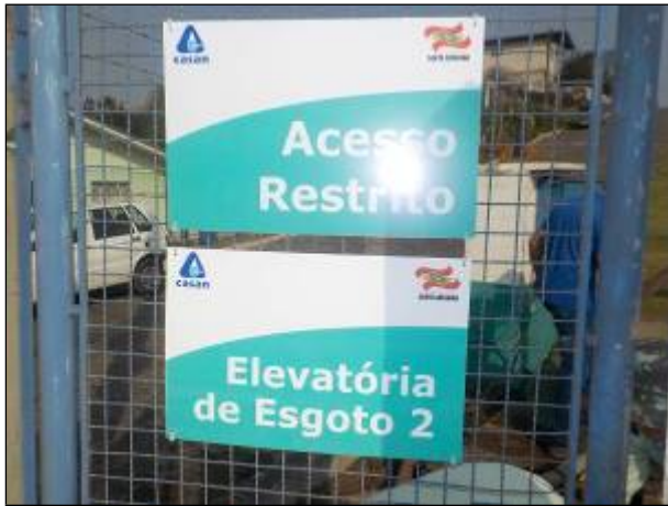
Figura 129: Vista do portão de acesso da EEE 02 contendo as placas de identificação e de restrição de acesso ao local.
