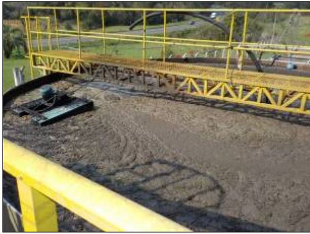
Figura 105: Equipamento aerador, em funcionamento, em um dos tanques.
