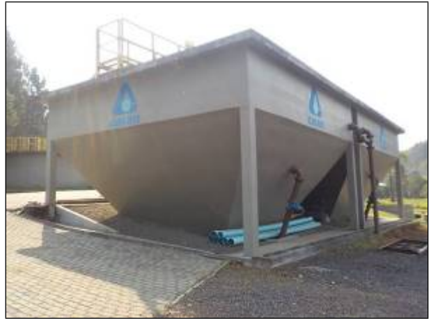
Figura 108: Vista parcial do local onde é realizada a decantação secundária na ETE Catanduvas.
