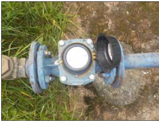
Figura 33: Detalhe do medidor de vazão do Poço 02, em Catanduvas.
