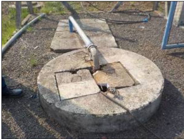
Figura 137: Vista da área interna da EEE 03.
