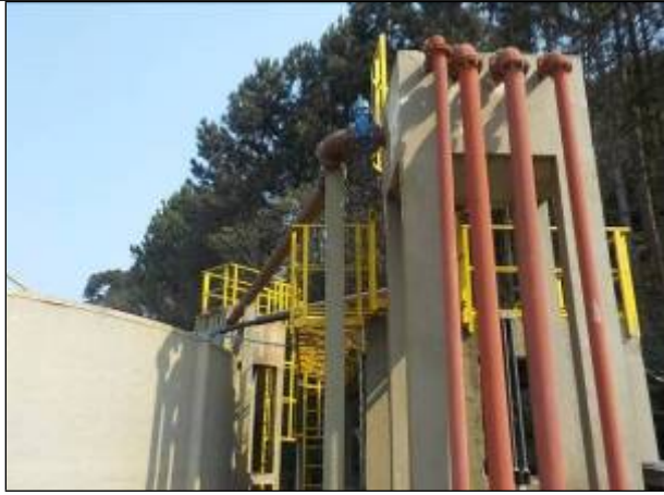
Figura 97: Destaque, à direita da imagem, das tubulações de esgoto bruto provenientes da própria rede e das EEE 01, 02 e 03.
