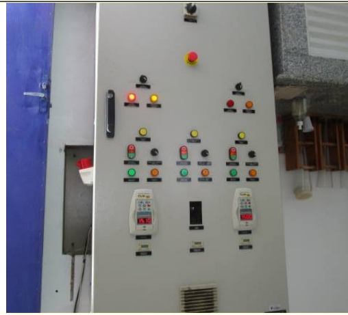
Figura 116: Vista frontal do painel de controle da ETE Catanduvas.
