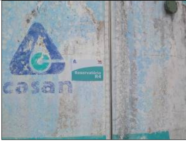
Figura 67: Detalhe da placa indicativa da unidade, o reservatório R-04, junto ao R-02.
