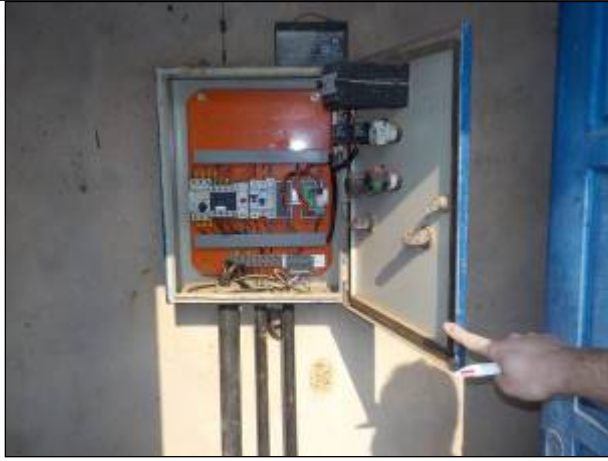
Figura 127: Vista do painel de controle da EEE 01.
