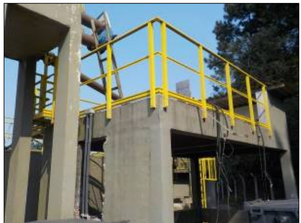
Figura 100: Vista lateral do local onde deveria estar o equipamento que realiza o tratamento preliminar do esgoto, no momento da vistoria indisponível.
