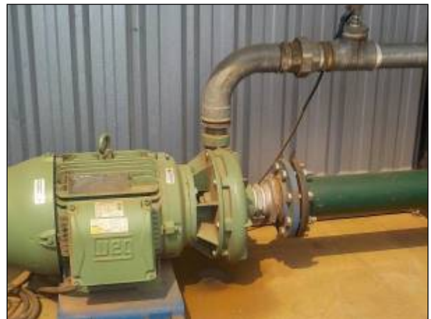
Figura 60: Detalhe da bomba de 20 CV que faz o recalque da água tratada dos reservatórios R-02 e R-04.
