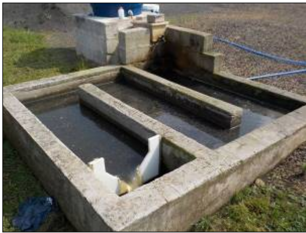
Figura 111: Vista geral do Tanque de Contato que auxilia na desinfecção (por hipoclorito de cálcio), processo final de tratamento de esgoto.
