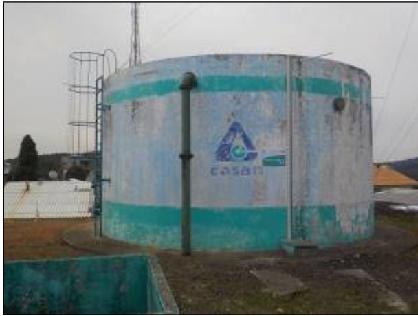
Figura 69: Vista parcial do R-04, a partir do R-02, mostrando sua escada e tubulação de entrada de água tratada.
