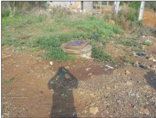
Figura 149: Vista da EEE 06, localizada em área próxima à EEE 04, sem cercamento e placas próxima ao Conj. Habit. Silvio Bitencourt.
