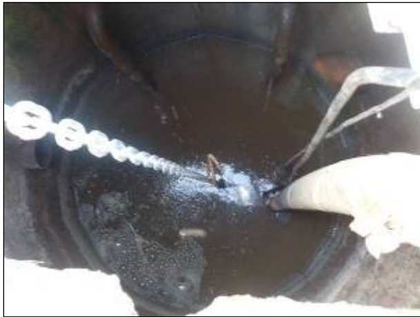
Figura 141: Detalhe do Poço da EEE 04.
