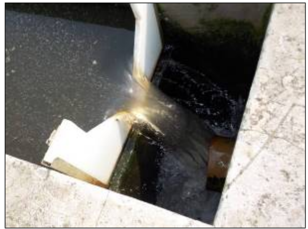
Figura 112: Produto final do tratamento de esgoto, após a cloração realizada no tratamento terciário, o qual será despejado no Lajeado Catanduvas.
