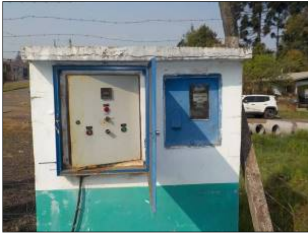
Figura 135: Vista externa do painel de controle e do medidor de energia elétrica da EEE 03.
