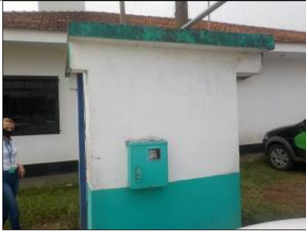
Figura 31: Vista da parede lateral externa do local onde o Painel de Controle está localizado.
