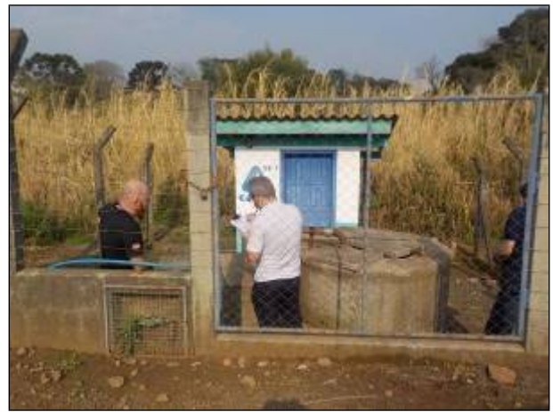
Figura 124: Vista parcial frontal da EEE 01, localizada às margens da Estrada da Pedra Lisa.
