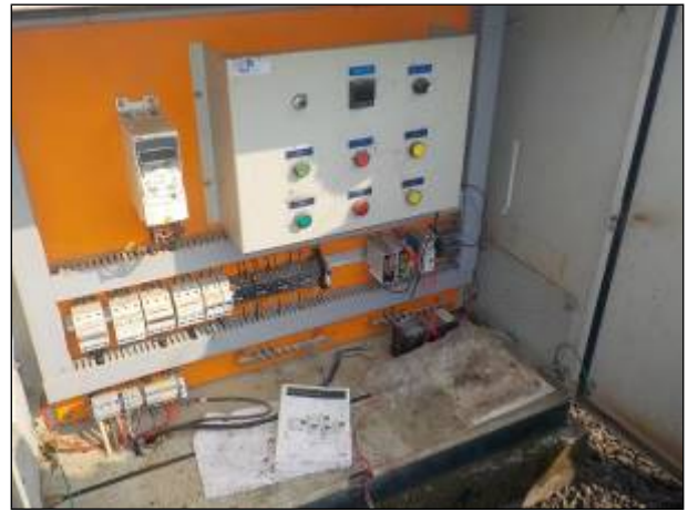
Figura 148: Detalhe do Pannel de Controle da EEE 05.
