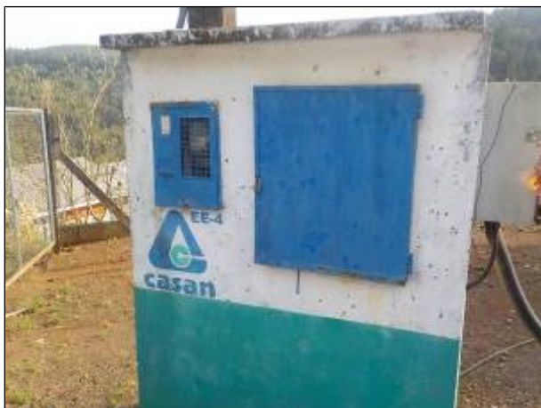
Figura 143: Vista do medidor de energia e das portas externas dos Painéis de controle das EEE 04 (ao centro) e EEE 06 (na lateral direita).
