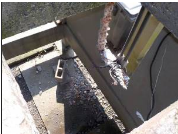
Figura 99: Vista superior da local onde deveria estar o equipamento que realiza o tratamento preliminar do esgoto, naquele momento estava indisponível e em manutenção.
