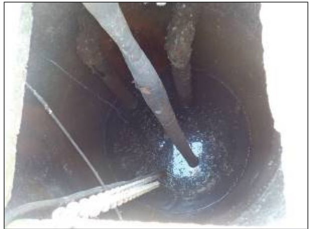
Figura 138: Detalhe do Poço de Sucção da EEE 03.
