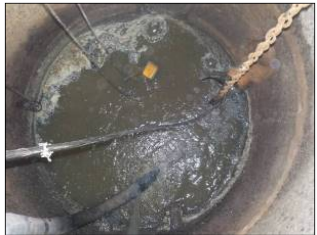
Figura 126: Vista do poço de sucção da elevatória de esgoto EEE 01
