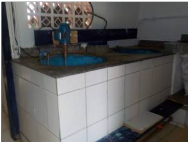
Figura 45: Área interna reservada para mistura dos produtos químicos utilizados no tratamento da água na ETA Catanduvás.
