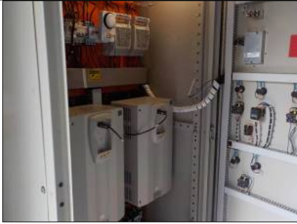
Figura 121: Detalhe da parte interna do Painel de Controle da ETE Catanduvas.
