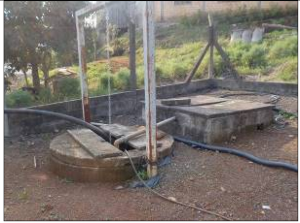
Figura 140: Equipamentos disponíveis na área da EEE 04; pode-se observar tubulação proveniente da EEE 06 carregando esgoto desta para o Poço da EEE 04.
