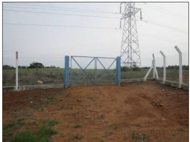
Figura 90: Vista da entrada de veículos no reservatório do Casagrande, o qual ainda não é parte do SAA Catanduvas.
