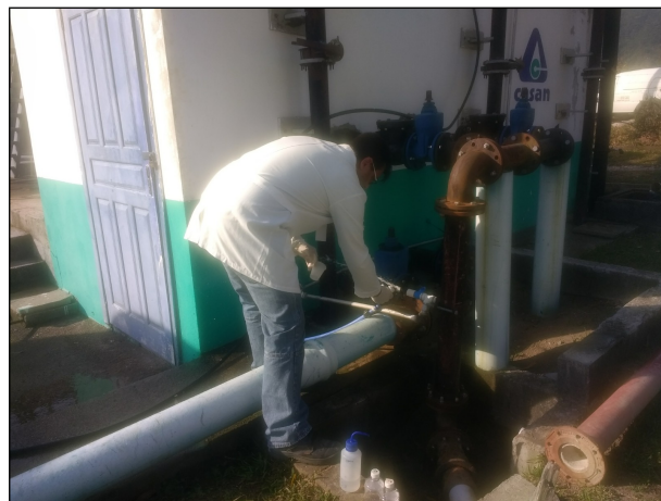
Figura 8: Coleta de amostra de água tratada na ETA Morro Agudo.
