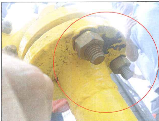
Figura 7: Falta de tratamento da superfície antes da pintura.
