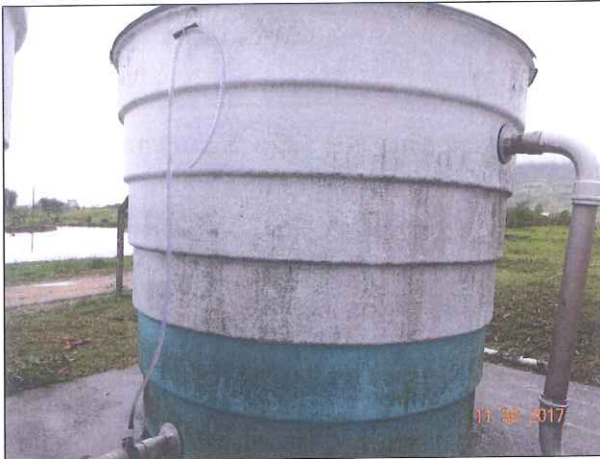
Figura 37: Reservatório Morro Agudo
