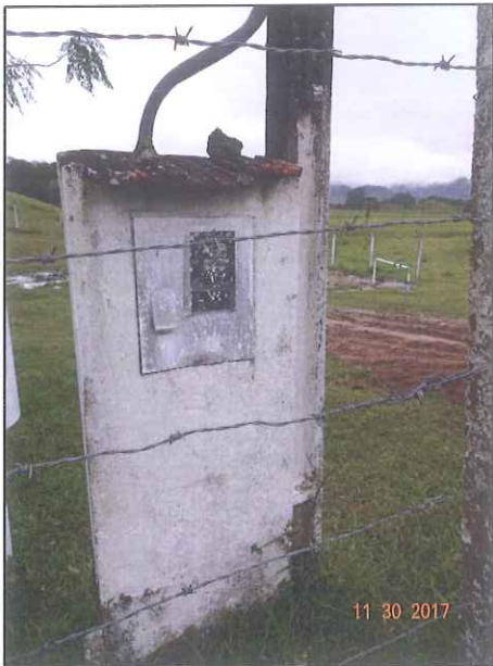
Figura 9: Captação Sorocaba: quadro de energia sem lacre
