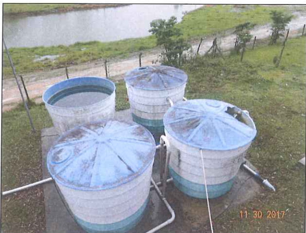
Figura 285: Reservatórios Morro Agudo
