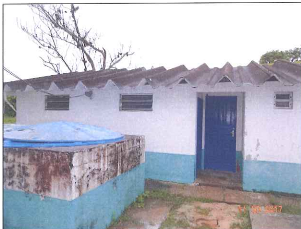
Figura 11: Unidade de tratamento Sorocaba
