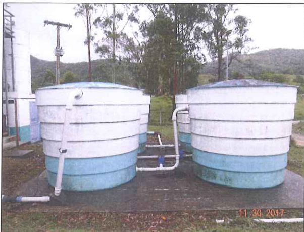
Figura 40: Reservatório Morro Agudo
