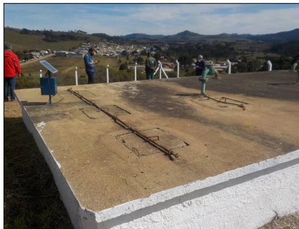
Figura 46: Vista da área superior do reservatório R2, contendo o painel de supervisão via remota (supervisório / telemetria).
