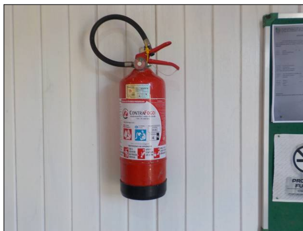
Figura 6: Vista do cilindro contendo pó químico extintor de incêndio em boas condições de uso (pressão, lacre e casco).
