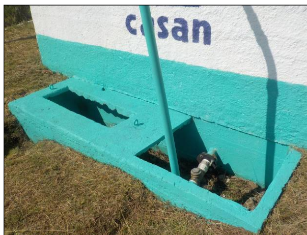
Figura 44: Vista da entrada da água tratada no reservatório R2.
