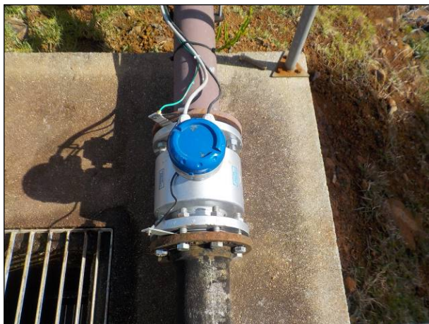
Figura 27: Vista do macromedidor disponível na ETA Bom Jardim da Serra.
