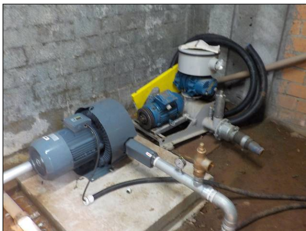
Figura 29: Equipamentos disponíveis para dosagem de produtos químicos no tratamento da água bruta na ETA.
