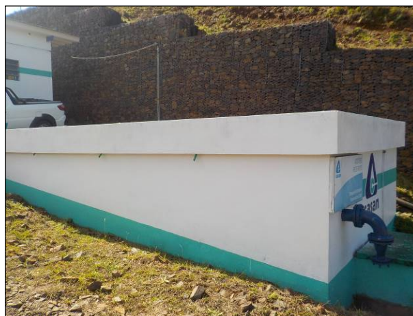
Figura 40: Vista do reservatório R1, com volume de 25 m 3 , junto à ETA.
