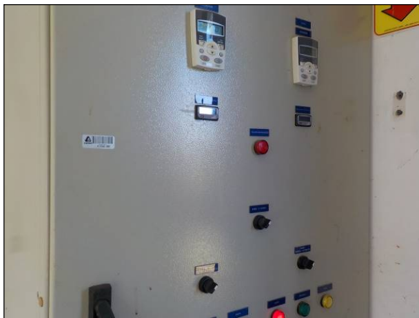
Figura 17: Vista do painel de controle da ERAB, funcionando e com telemetria, porém sem placas indicativas de eletricidade e/ou perigo.
