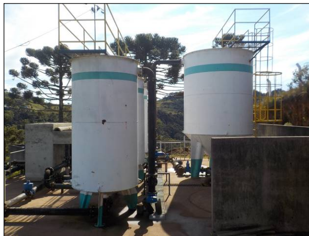
Figura 22: Vista dos equipamentos disponíveis na ETA Bom Jardim da Serra.
