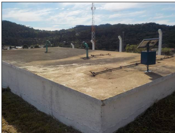
Figura 45: Vista da área superior do reservatório R2, contendo o painel de supervisão via remota (supervisório / telemetria).
