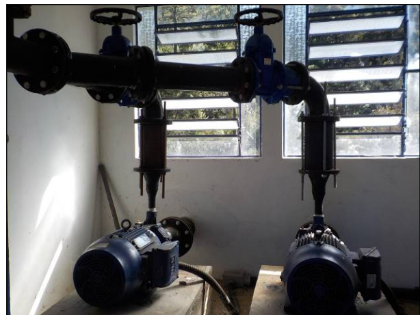
Figura 18: Vista das bombas disponíveis na ERAB, sendo uma destas reserva.
