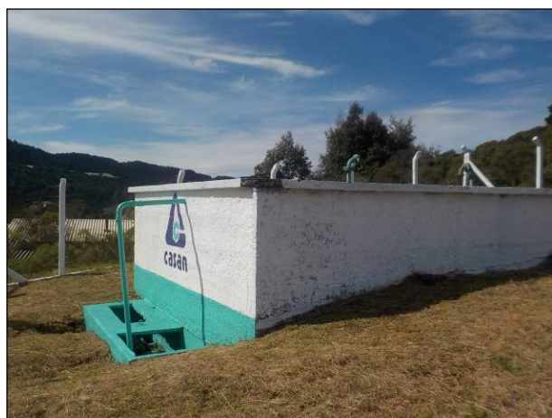
Figura 43: Vista do reservatório R2, em bom estado estrutural e em local cercado adequadamente.
