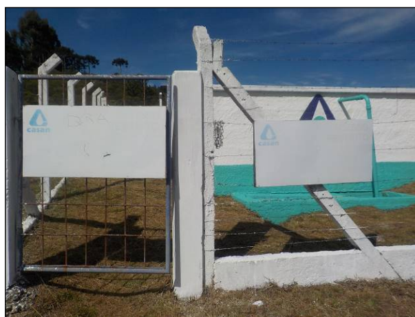
Figura 42: Vista do portão de entrada e das placas indicativas da unidade reservatório R2, estas em condições insatisfatórias.
