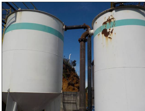
Figura 24: Vista dos equipamentos disponíveis na ETA Bom Jardim da Serra; ferrugem aparente.
