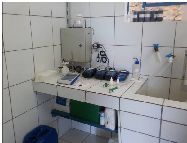
Figura 34: Local com equipamentos para análise da água tratada no local.
