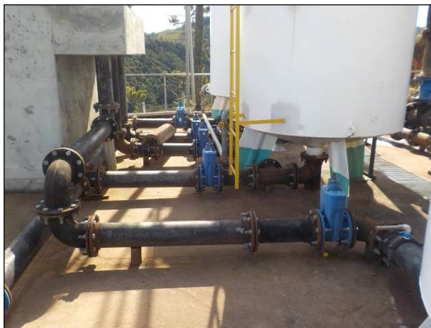
Figura 21: Vista dos equipamentos disponíveis na ETA Bom Jardim da Serra.
