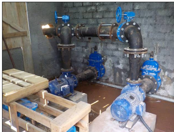
Figura 28: Vista das bombas disponíveis junto à ETA.
