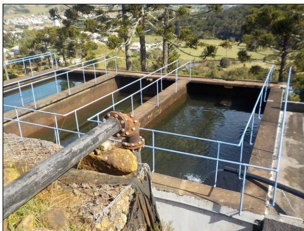
Figura 25: Vista dos filtros lentos em operação no momento da vistoria.
