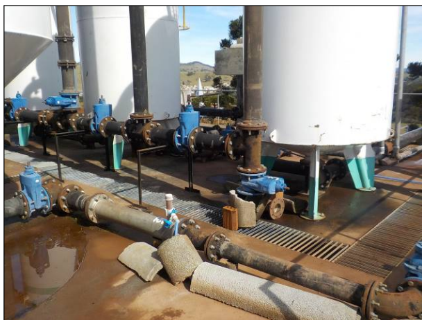
Figura 23: Vista dos equipamentos disponíveis na ETA Bom Jardim da Serra.
