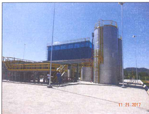
Figura 14: Vista da Unidade de tratamento de lodo.
