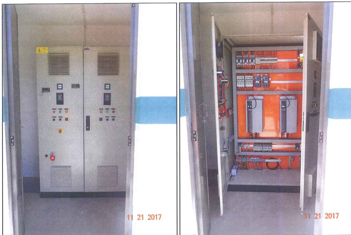
Figura 3: Quadro de comando da EEE C1.
