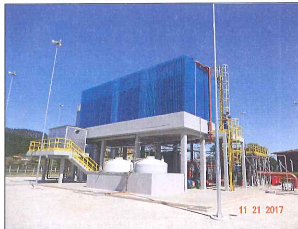
Figura 11: Vista do Filtro biológico percolador.
