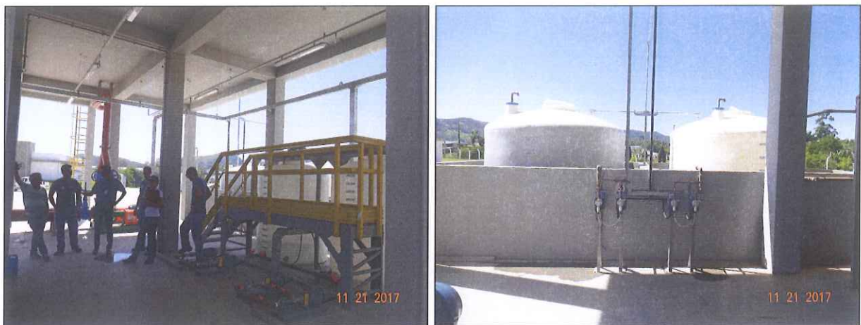
Figura 13: Tanques de produtos químicos da ETE Braço do Norte.
