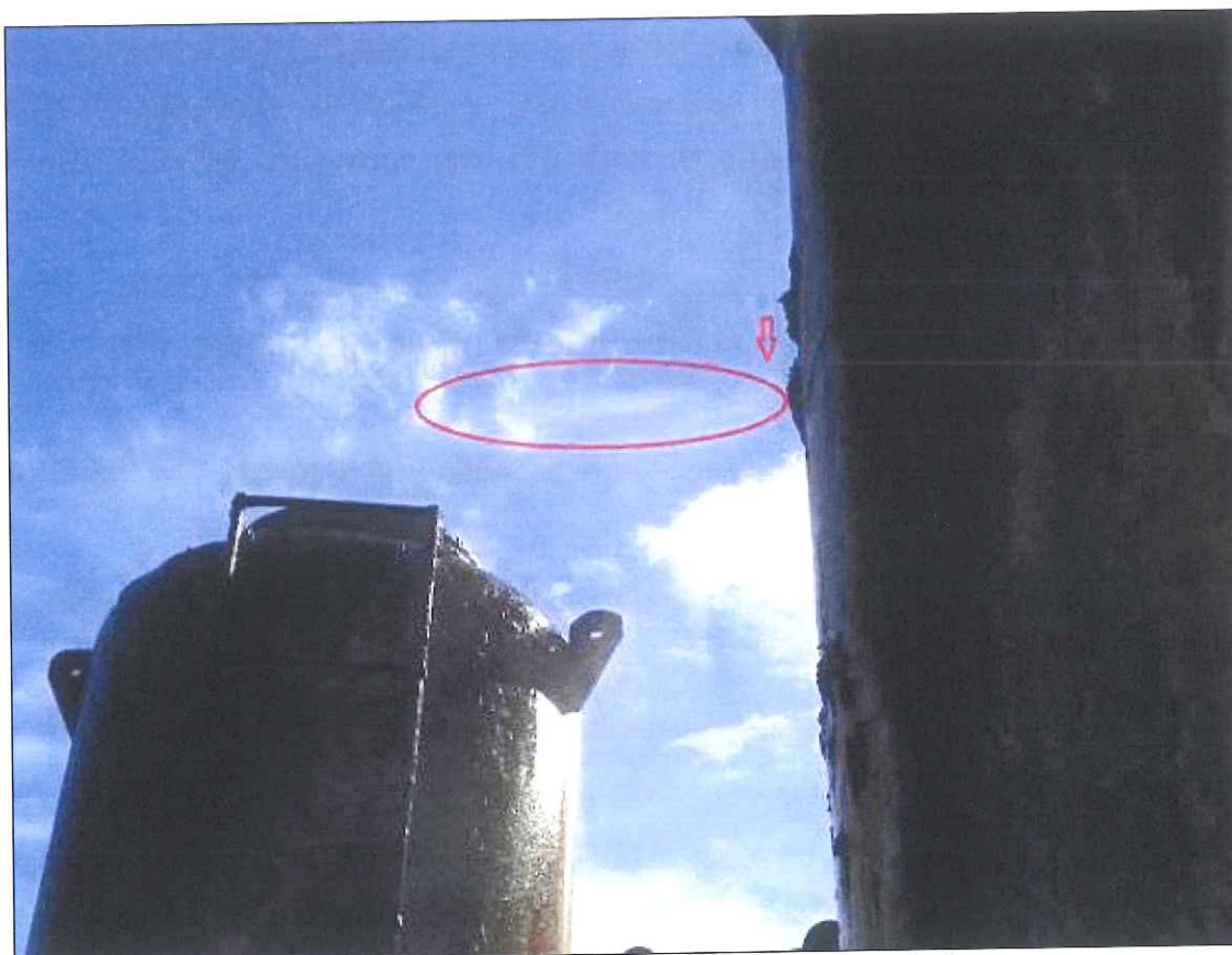
Figura 7: Grande vazamento de água no decantador.
