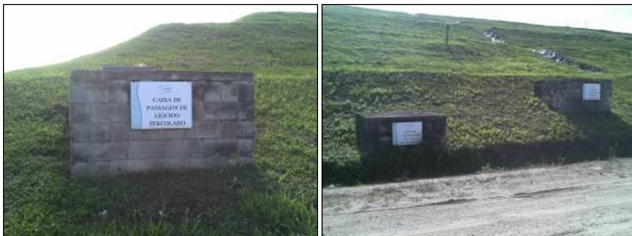
Figura 129: Equipamentos para tratamento do chorume
