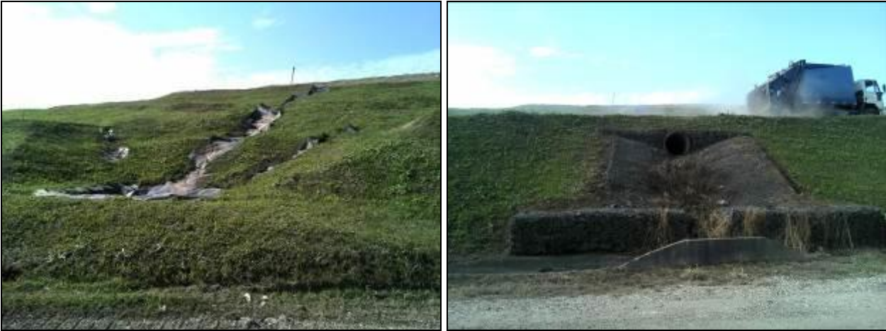
Figura 11: Drenagem de águas superficiais
