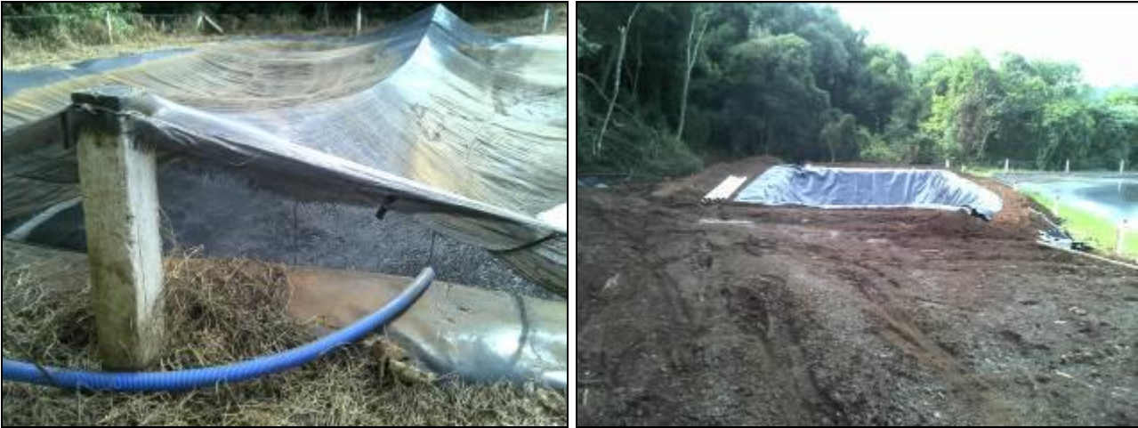
Figura 16: Equipamentos para tratamento do chorume
