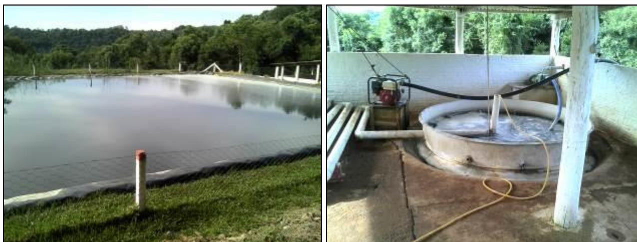
Figura 15: Sistema de tratamento
