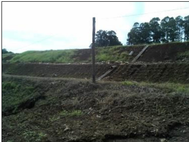
Figura 13: Drenagem de águas superficiais
