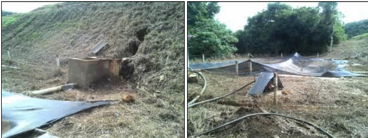
Figura 14: Sistemas de drenagem/tratamento
