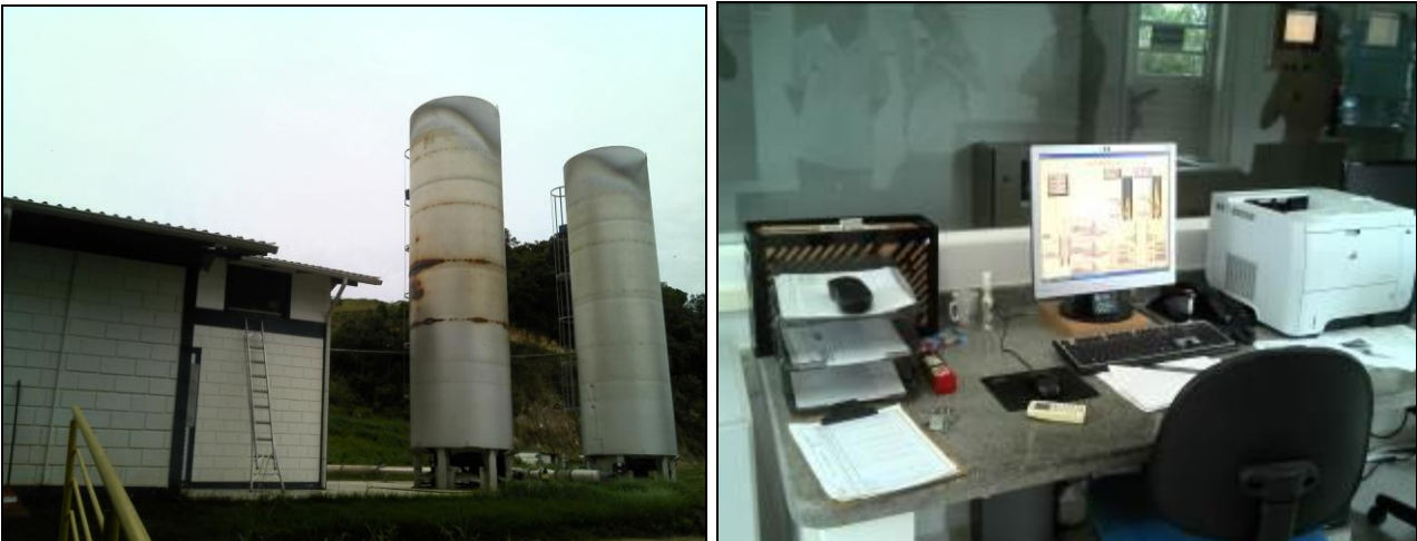
Figura 13: Queimadores de Gases e Painel de controle
