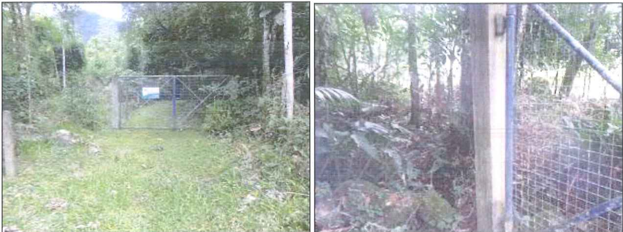
Figura 8: Passagem livre, cerca e portão de acesso danificados
