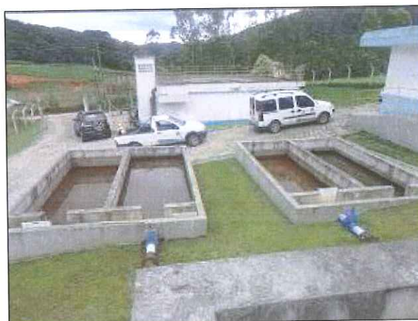
Figura 14: Leito de secagem do lodo
