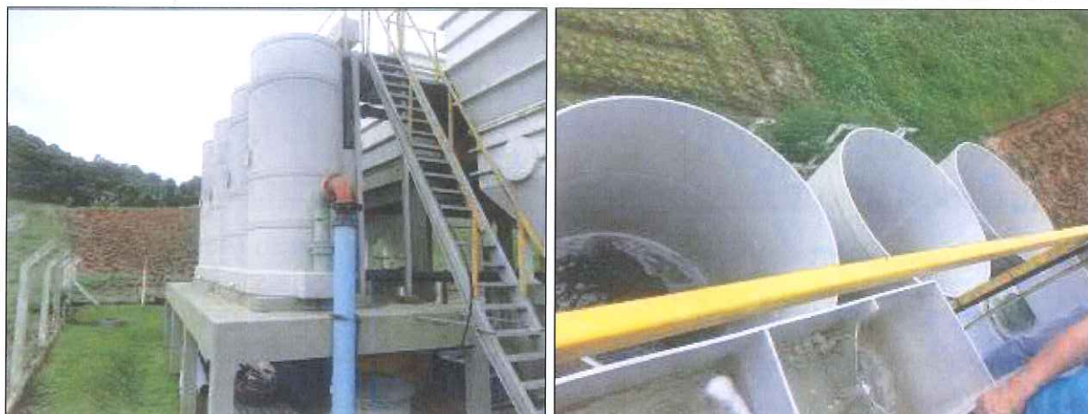
Figura 15: Filtro da ETA
